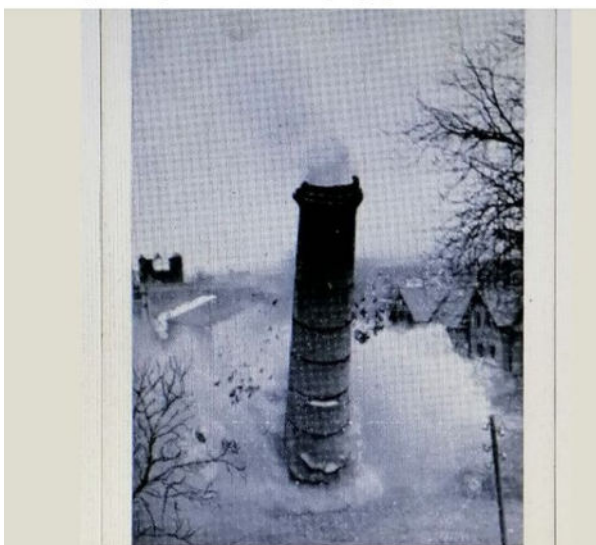
Der stürzende Schlot auf Schacht I des Kalibergwerkes in Vienenburg - wenige Sekunden nach der am 3. April 1936 erfolgten Sprengung.
