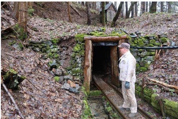
Inaugenscheinnahme der kaputten Trockenmauer
